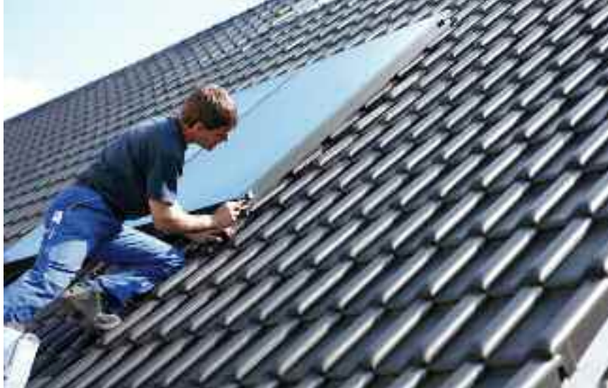
Eine Solarthermie-Anlage erzeugt Wärme und unterstützt die Heizung und Warmwasser-Aufbereitung.
