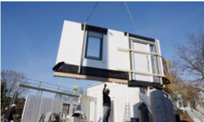
Ein Schwerlastkran hievt die Wände vom LKW. Wichtige Teile wie Fenster und Türen sind bereits montiert.
